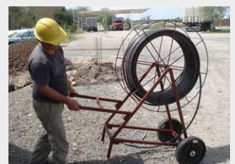
■ TRANSPORTE DE CINTA DESTAPACANERÍAS DE LAGUNAS DE TRATAMIENTO
