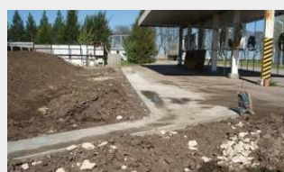
■ DESAGUE ZONA TUNEL ESPERA Y DESENGRASADOR NUEVO
